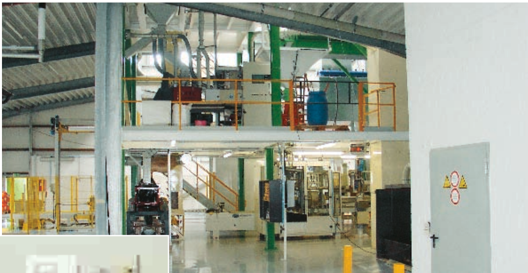
2007 wurde die Beizanlage der Meiners Sedema Saaten GmbH komplett erneuert und erweitert.
